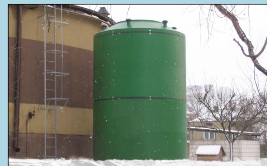
Instalacja do oczyszczania powietrza BW-2000 przy przepompowni ścieków w Suwałkach
